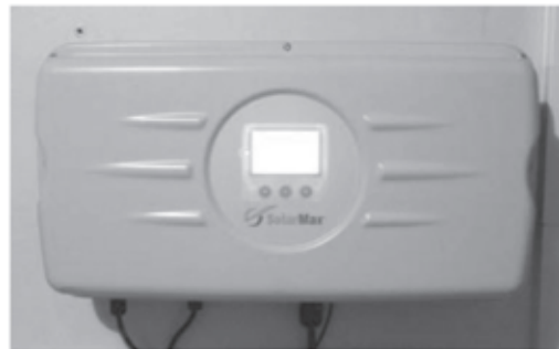
Figure 9. – Onduleur relié aux panneaux photovoltaïques
