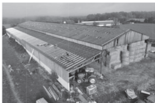
Figure 6. – Installation photovoltaïque dans une exploitation agricole ( http://www.photowatt.com )
